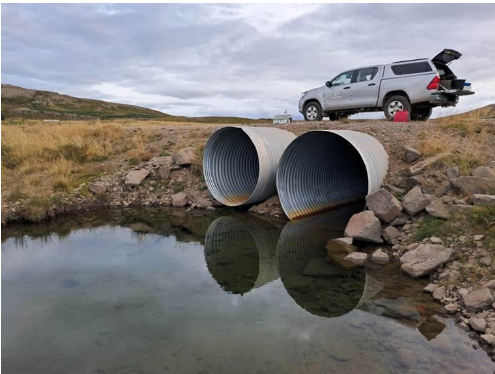
D) Hrappsá á Skógarströnd. Vinstra ræsið (frá vegi séð) er vel sett, enginn stallur neðan við það, gott dýpi og hægur straumur. Hægra megin er aukaræsi fyrir mikið rennsli.
